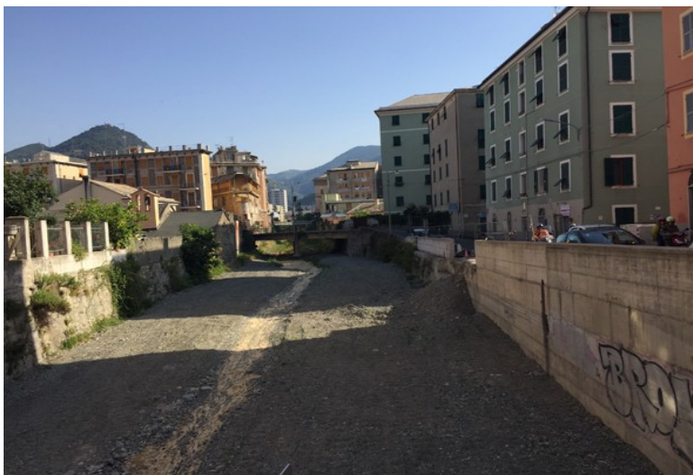
Fotografia 10 tratto 3 torrente Chiaravagna. Vista verso nord ripresa da Via Giotto. Si vede il ponte di Via Chiaravagna.
